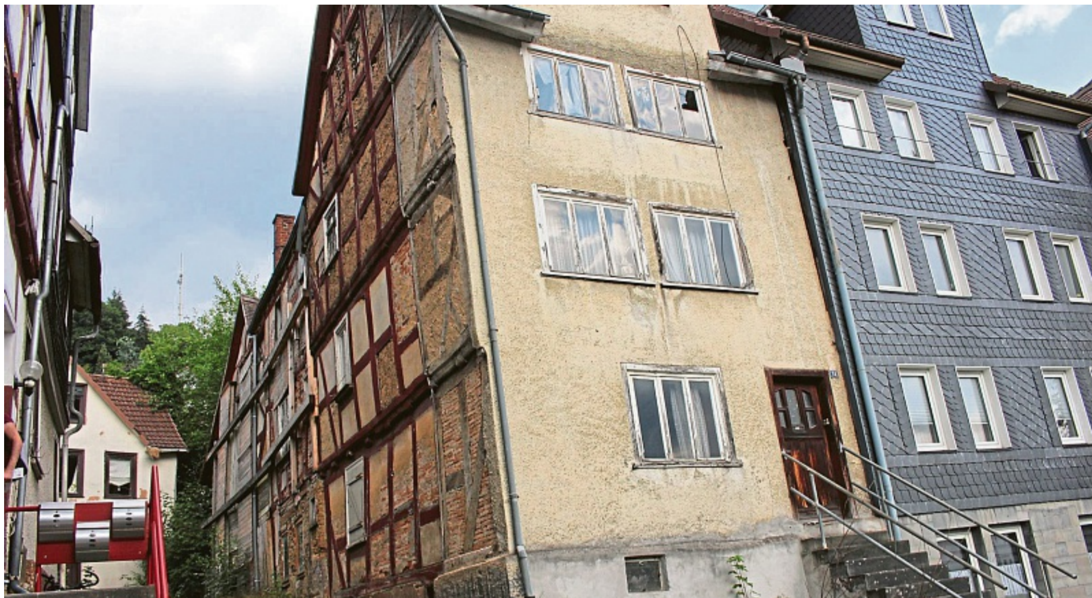
Das Problem des Leerstands von Wohnungen findet sich auch in der Altstadt von Biedenkopf in der Nähe des Marktplatzes.
